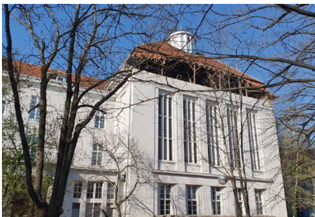
Zgrada starog dekanata sa znatnim oštećenjem krova
