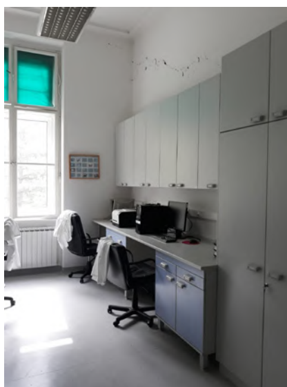
Kosa pukotina u vanjskom zidu Zavoda zbog koje ovaj laboratorij Zavoda nije upotrebljiv
