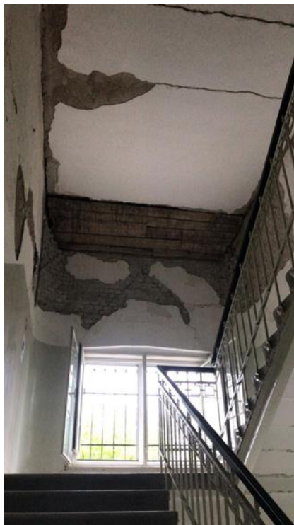
Oštećenja zavodskih stuba
