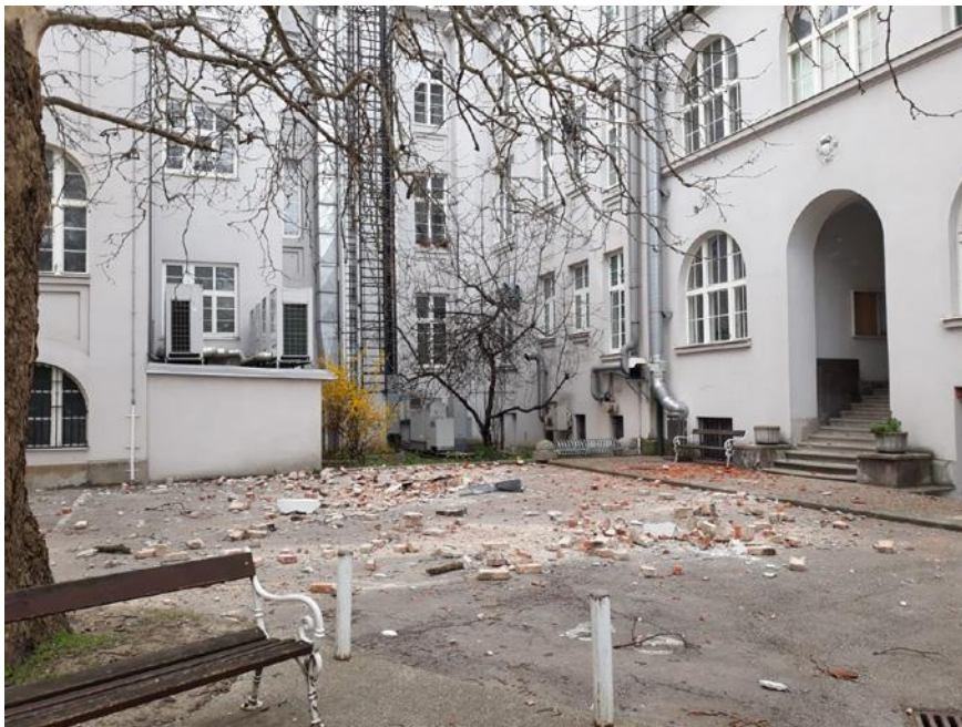
Ulaz na Zavod bio je zatrpan urušenim materijalom s krova
