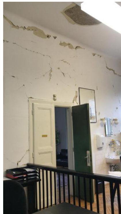
Ured Zavoda nakon potresa
