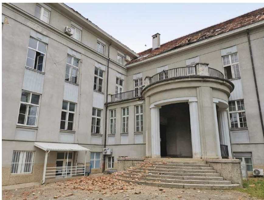
Križne pukotine ispod EM centra
