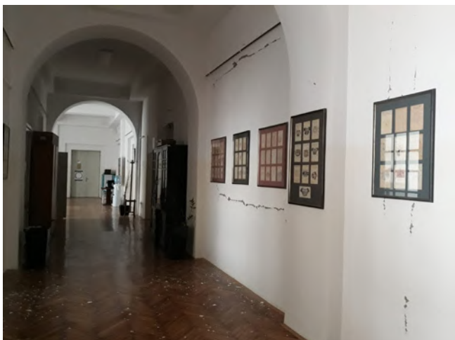
Vodoravne i okomite pukotine u pregradnim zidovima Zavoda koje su sanirane nedavnom obnovom
